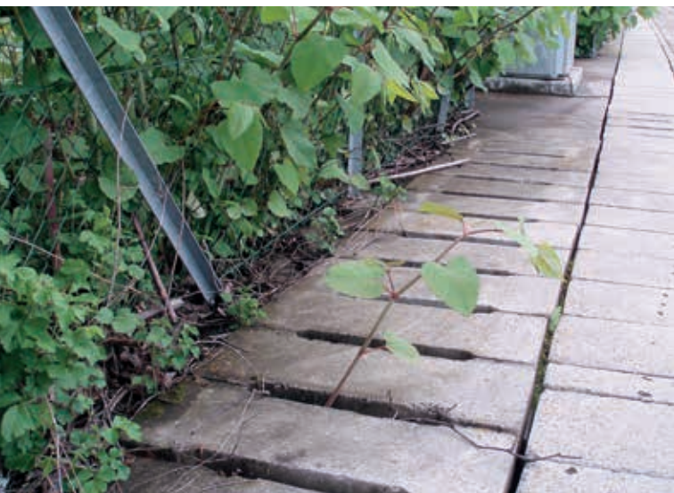
Staudenknöterich kann auch in Kabelkanäle und Entwässerungen einwachsen
