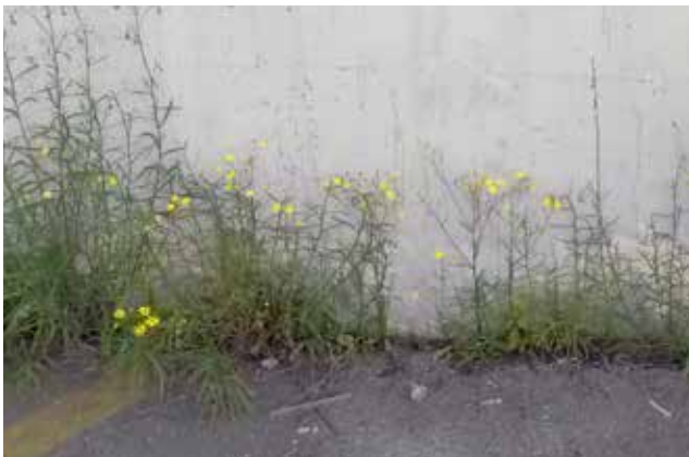
Südafrikanisches Greiskraut wächst aus Mauerfugen am Bhf Innsbruck (© ÖBB)
