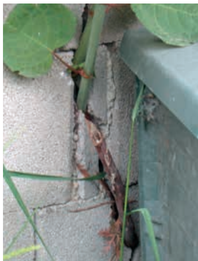
Staudenknöterich kann in die kleinsten Ritzen einwachsen und Bauwerke aufsprengen
